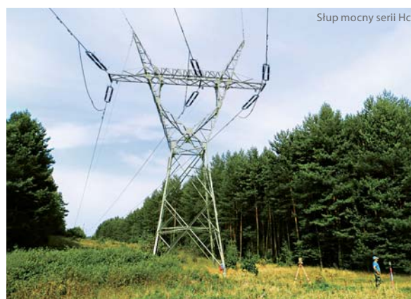
Linia elektroenergetyczna 220 kV relacji Łośnice – Kielce
